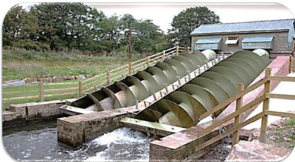
Fig. 4. Microhidrocentrală echipată cu turbine tip șurubului lui Arhimede
