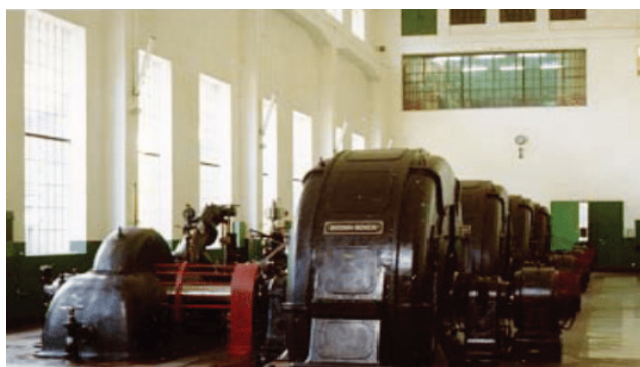
Fig. 4. CHE Dobrești - Sala mașinilor [4]
